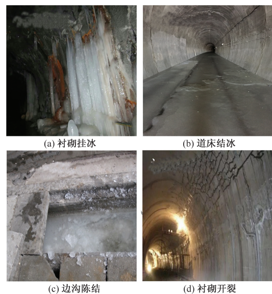
图 1 高寒隧道冻害
