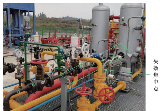
图 3 排污气管线易失效位置
