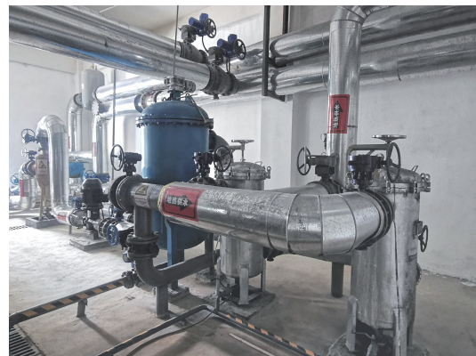
(a)换热站前端
