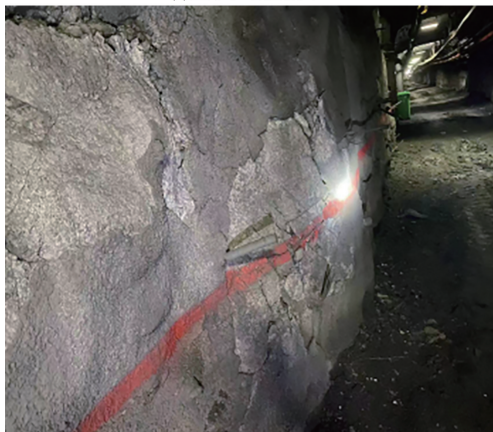
(b)柴家沟矿巷道破坏
