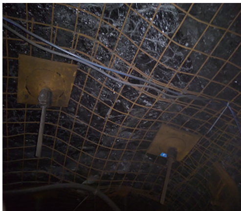
(a)玉华矿巷道破坏
