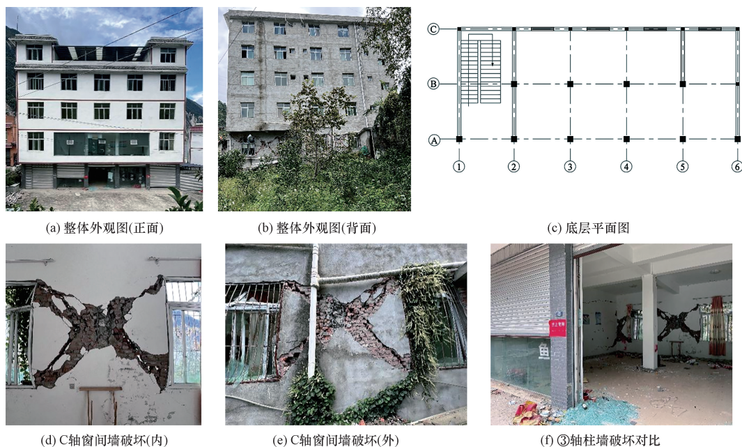
图2 得妥南头1组7号建筑震害
