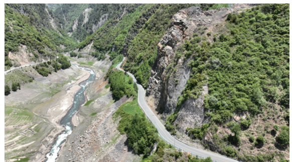
图6 危岩崩塌后落石停积位置
