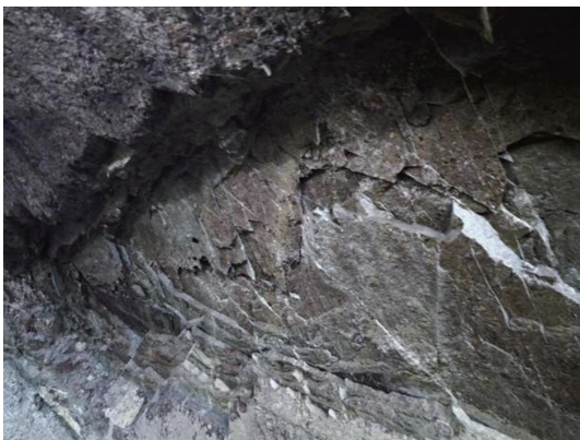
图 1 围岩顶板垮塌情况
