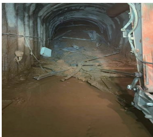
(a) 隧洞冒顶塌方
