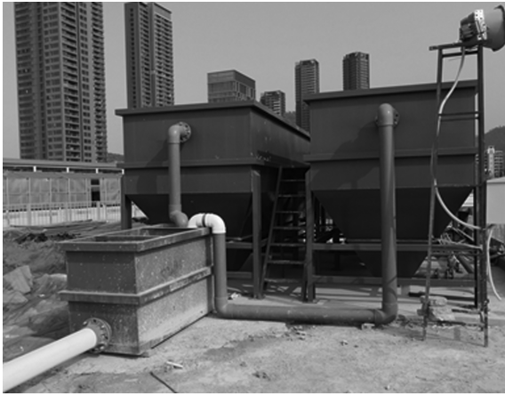
图 5 两台净化处理设备并列安装
