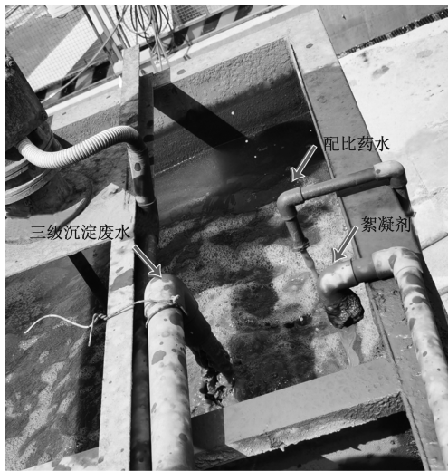
图 13 污水、絮凝剂、混合药剂同时泵入反应槽
