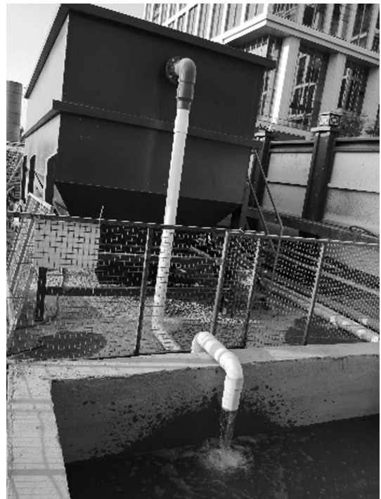
图 15 清水槽水排至清水池
