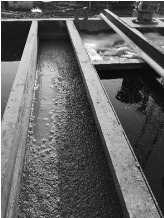
图 14 配水区缓冲、静置
