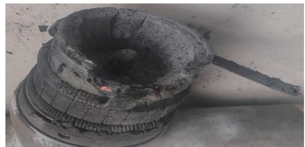
图 6 损坏下线的-1 刀闸动静触头烧蚀情况
