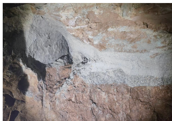
图4 掌子面疏松砂岩层“管涌”状破坏
