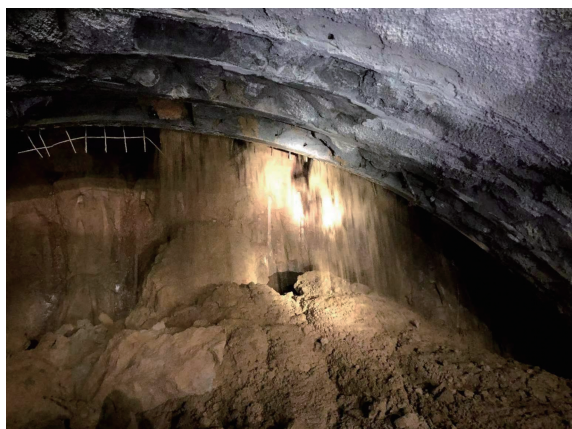
图3 掌子面泥岩顶板坍塌
