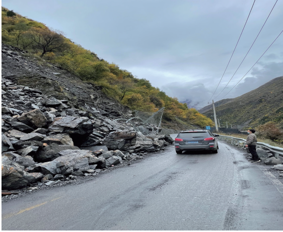
图 2 浆砌挡土墙+被动网损毁情况
