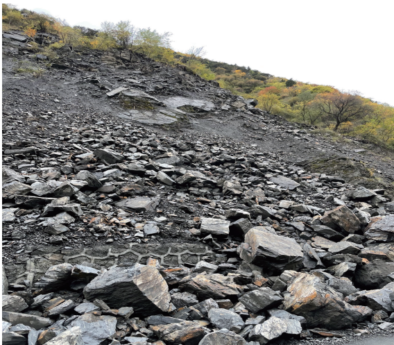
图 3 浆砌挡土墙被掩埋堆积
