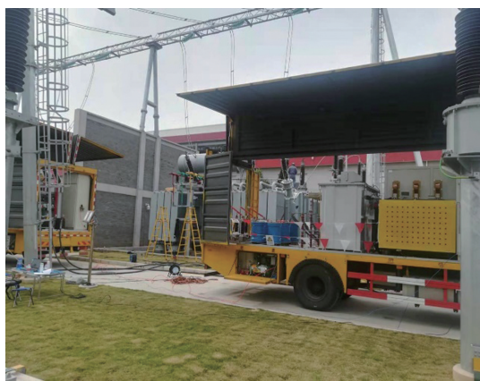
图11 空负载试验平台1号车和2号车试验现场
