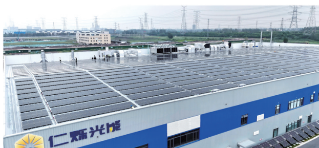
仁烁光能兆瓦级屋顶电站
