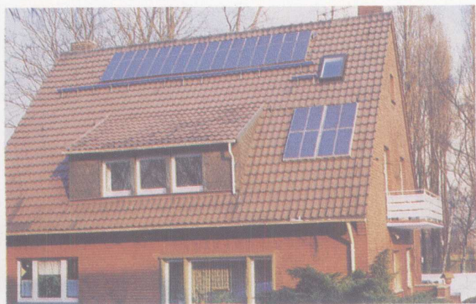
装在斜顶屋上的光伏设备(1.5千瓦)
