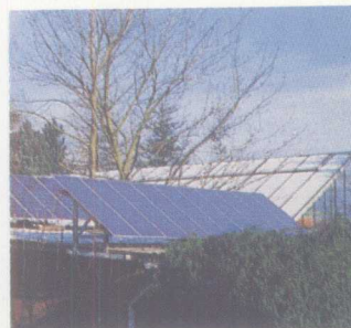
装在平房上带标准框架的光伏设备(3千瓦)
