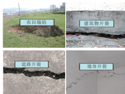
图1 金竹山矿业公司土珠煤矿地表塌陷图
