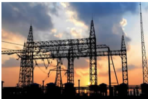
图 14 晋东南—南阳—荆门特高压试验示范工程建成并投入运营 (图片来源:国际电力网)
