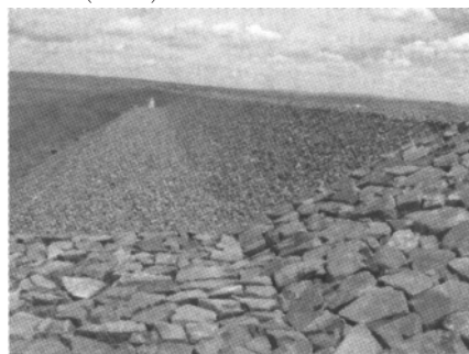
图4 北麓河坡碎石护坡试验 碎石直径: 5\sim 8\text{cm} 和 40\sim 50\text{cm}
