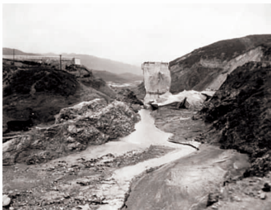
图 2 美国 65 m 高的 St. Francis 混凝土大坝于 1928 年 3 月 12 日溃决后的残留 Fig. 2 Remnant of the 65 m high concrete St. Francis Dam after failure on 12 March 1928, USA (source: Chanson, 2005)
