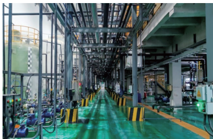
萃取提锂示范工程
