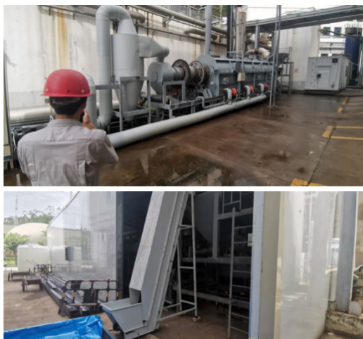
图4 中试示范装置及运行现场
