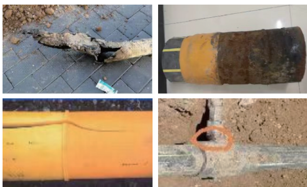
图1 服役过程中的 HDPE 压力管道典型失效模式
