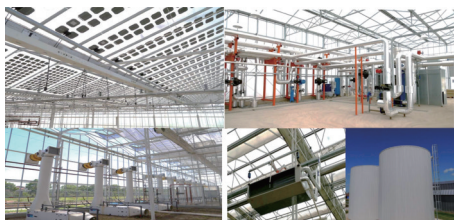
图3 国家设施农业中心崇明农业示范基地含水层储能系统
