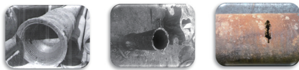
(a) 接头过量变形 (b) 管体断裂 (c) 管体表面损伤
