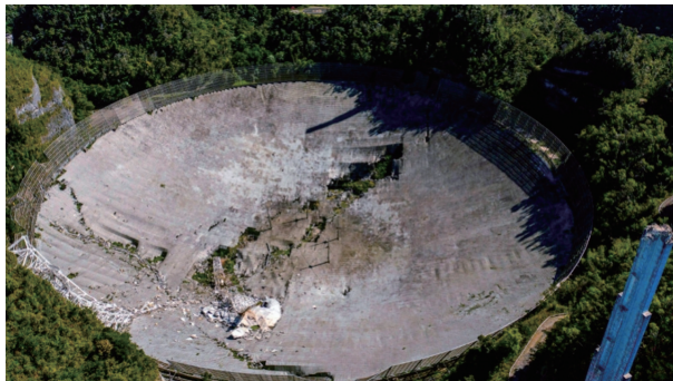
图3 坍塌的阿雷西博望远镜
