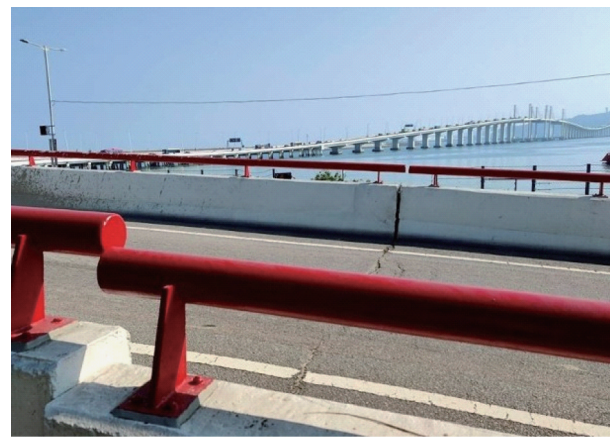
图12 澳门友谊大桥引桥位置桥面出现裂缝 [12]
