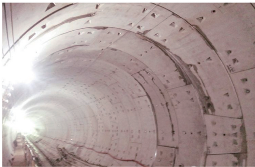
图4 止水条损坏后难以修复的盾构隧道
