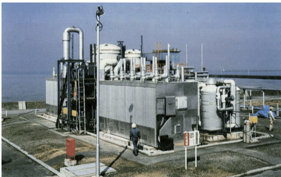
图 14 日本 PAFC 燃料电池发电装置
