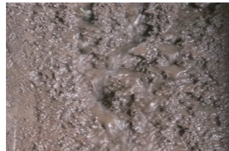
图2 裸土冲刷侵蚀
