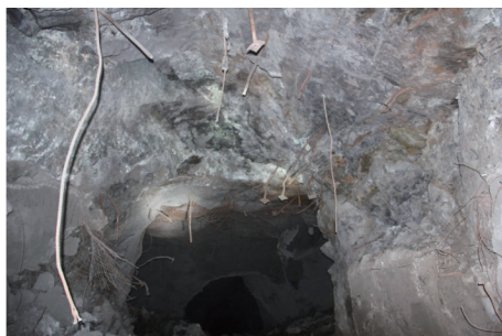
图7 蛇纹岩层顶板冒落
