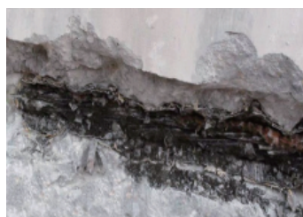
图 13 现场破损开的注浆不密实孔道图 Fig. 13 On-site broken and non-dense grouting channel
