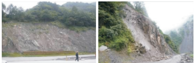
图5 治理的崩塌体 (K20+532—K20+750)
