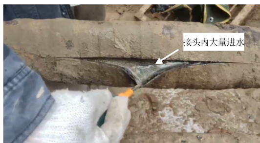
图9 受潮接头的现场照片
