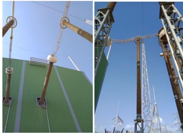
(a)高端穿墙套管 (b)±800 kV 母线支柱绝缘子
