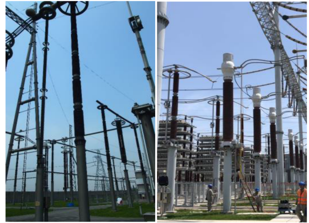
(a)±800 kV 母线支柱绝缘子 (b)500 kV 交流支柱绝缘子
