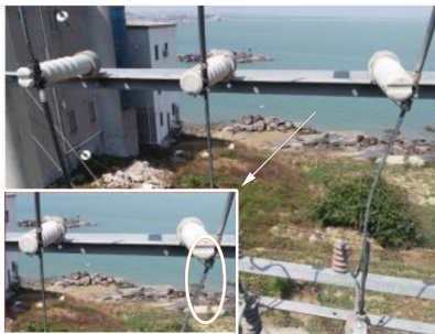
图1 绝缘导线绑扎处烧蚀
