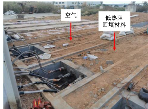
图4 试验回路排管实物图
