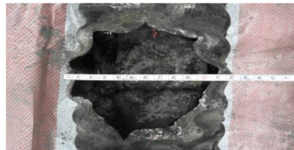
图1 110 kV XLPE故障绝缘电缆击穿点
