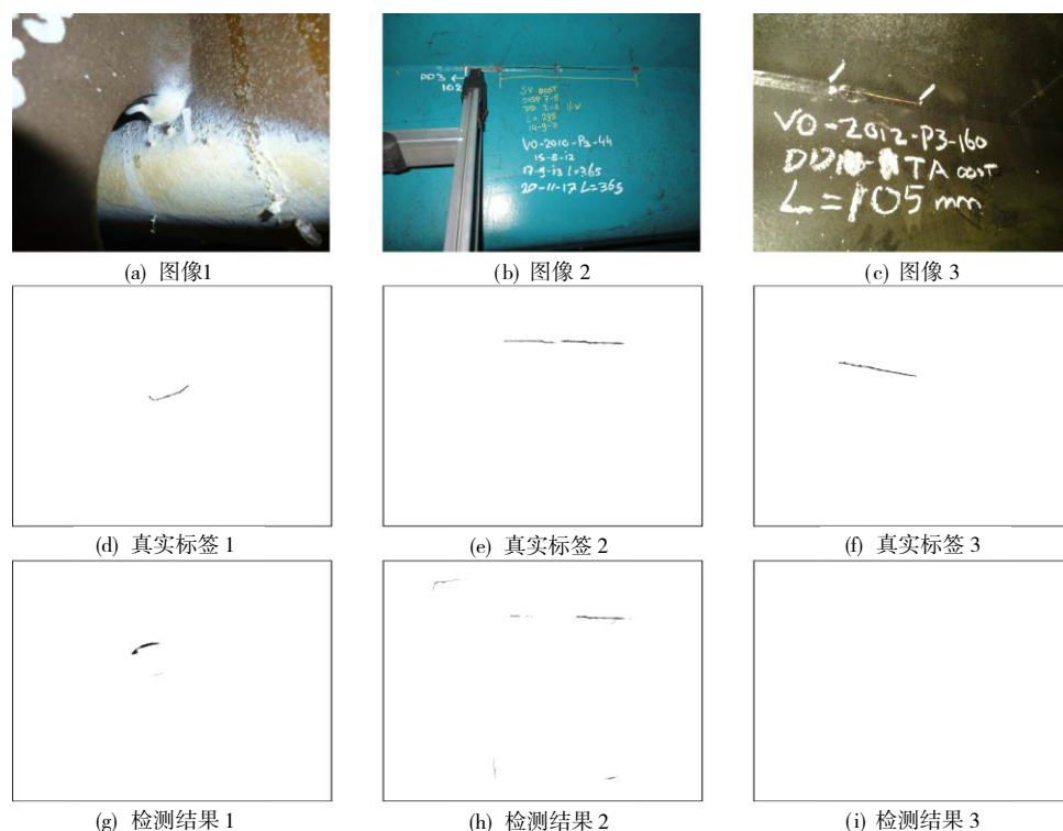
图4 钢箱梁裂纹检测失败案例 [51]
