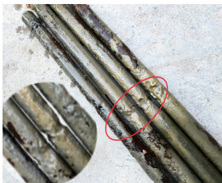
图 6 锈蚀钢筋截面损失实图 Fig. 6 Section loss of corroded rebars
