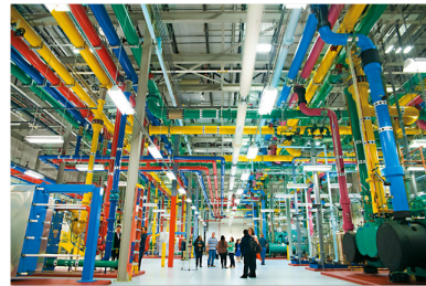
图 8 Google 数据中心的液冷系统
