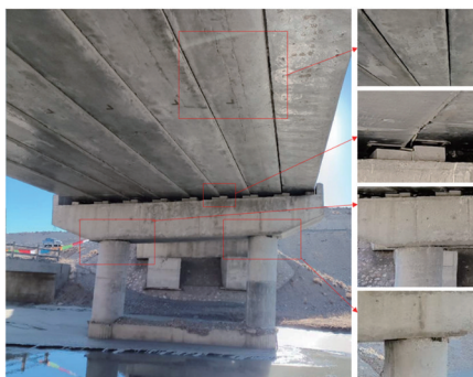
(c) 2号墩不均匀沉降倾斜导致墩顶钢筋裸露
