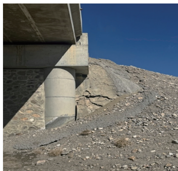
(d) 0号桥台锥坡严重开裂
