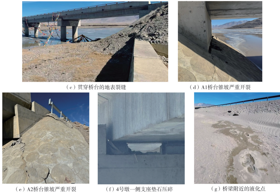
图 2 国曲线 X222 线 2 号桥震害
