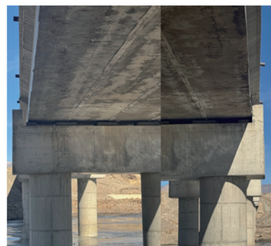
(e) 4号墩上梁发生水平侧移
