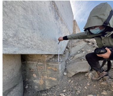
(h) 6号桥台处路基发生21 cm沉降
