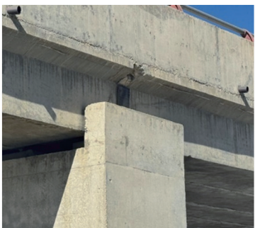
(f) 4号墩上梁发生碰撞, 混凝土剥落
