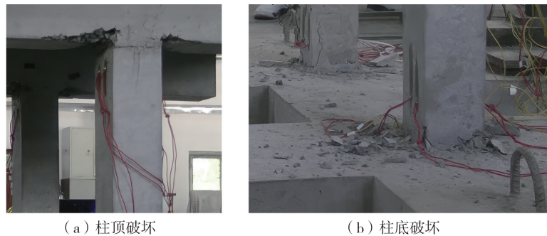
图5 未加固柱破坏情况
