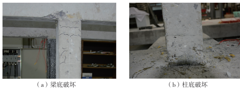
图6 加固柱破坏情况
