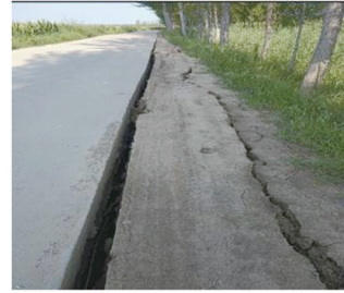
图 9 液化造成的公路路肩破坏
