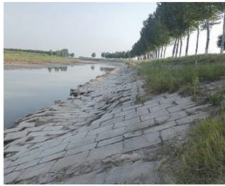
图 8 液化造成干渠堤岸破坏
