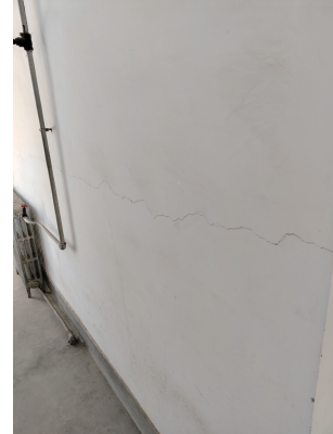
图16 泵房填充墙抹灰层开裂
