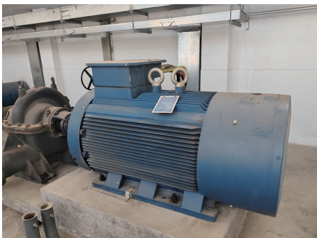
图 7 2 号 355 kW 供水泵停止运行 Fig. 7 Water supply pump No.2 with 355 kW capacity halted
