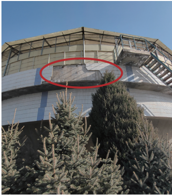
图15 预沉池顶部瓷砖掉落
