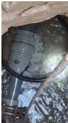
图20 大河家镇管道连接处破坏漏水(8度区)
