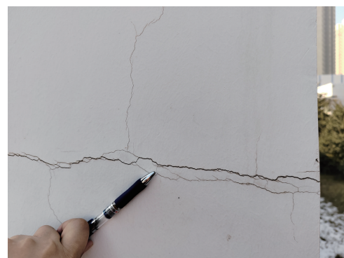
图14 1号清水池抹灰层开裂
