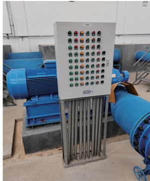
图 3 第六号电泵停止运行 Fig. 3 Pump No.6 stopped operating
