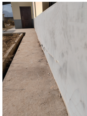
图18 外墙保温层开裂
