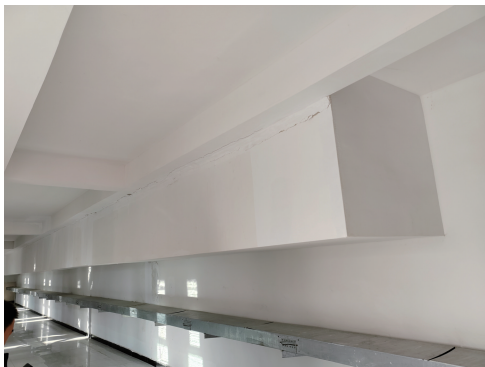
图11 导流槽与相邻框架梁之间出现裂缝
