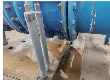
图 8 法兰连接处渗漏 Fig. 8 Leakage at flange connections
