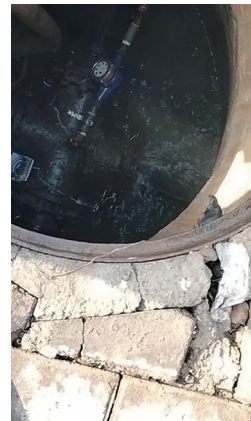
图21 石塬镇管道连接处破坏漏水(8度区)
