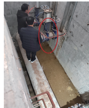
图12 导流槽下部管道法兰连接处渗漏
