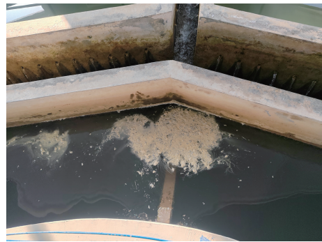
图10 刮泥机漏油污染水质
