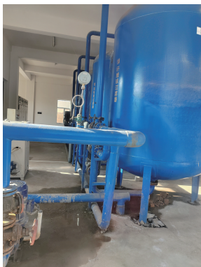
图17 法兰连接处大量漏水
