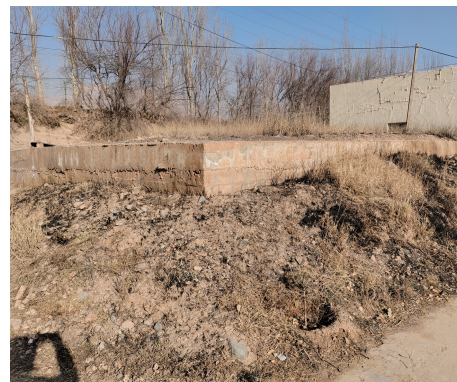
图19 清水池顶部水平裂缝
