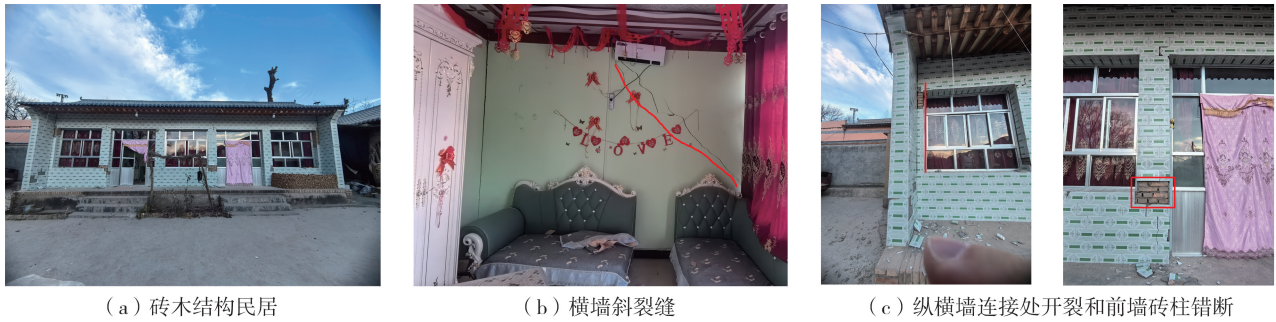
图 3 普通砖木结构震害
