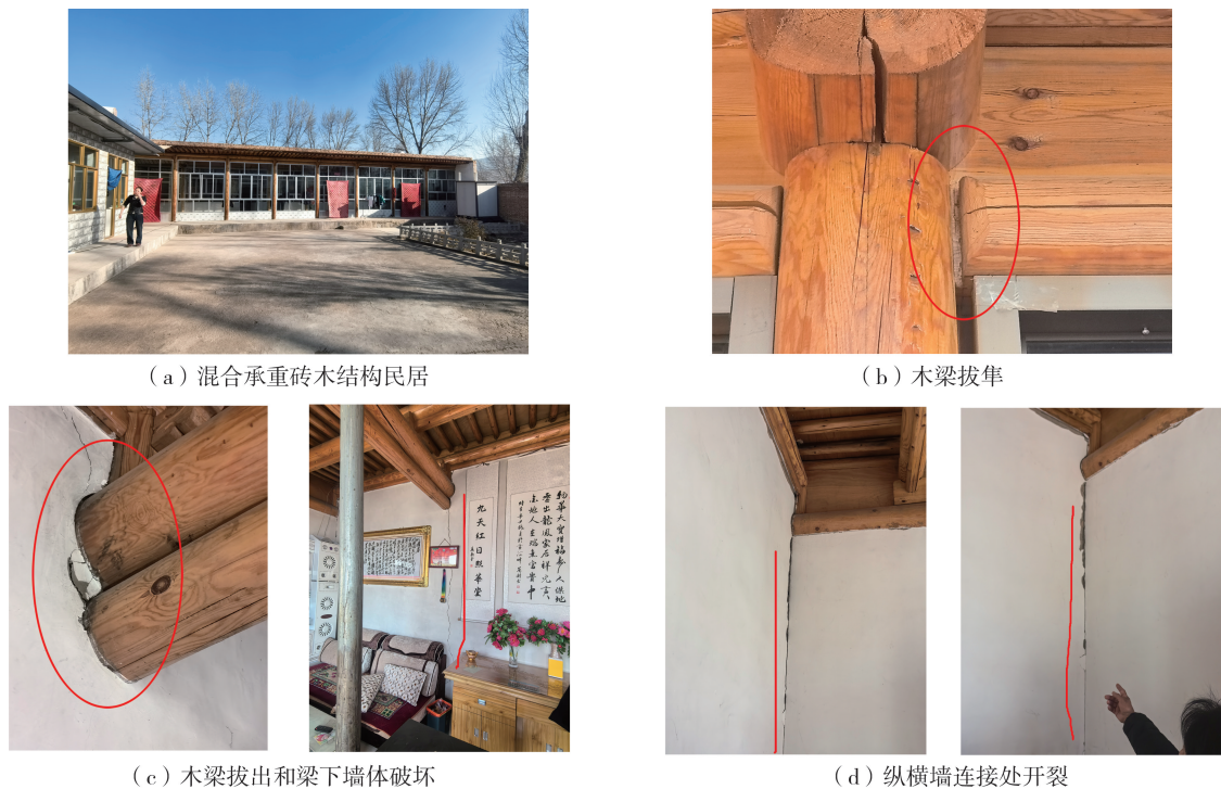
图 4 混合承重砖木结构震害
