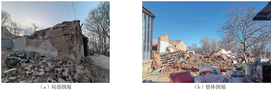
图 2 土木结构房屋局部倒塌与整体倒塌
