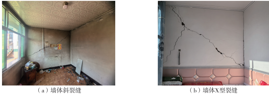
图5 无约束砌体墙体破坏
