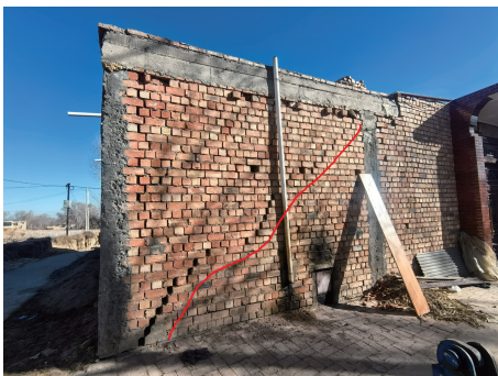
图 12 墙体沿灰缝破坏
