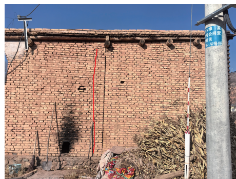
图 17 木梁底下墙体存在竖向施工通缝
