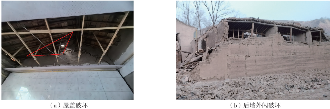
图 1 土木结构房屋屋盖破坏与墙体破坏
