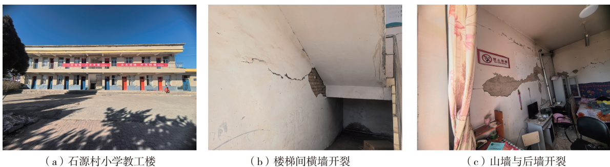
图7 设防砖混结构房屋震害
