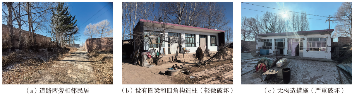
图6 有无构造措施砖混结构房屋震害对比
