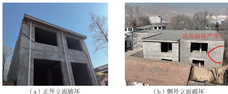
图6 大河家镇某内框架结构墙体严重破坏
