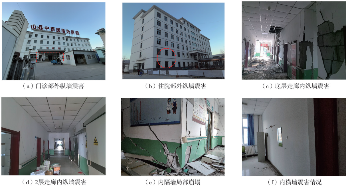
图7 门诊部、住院部震害情况
