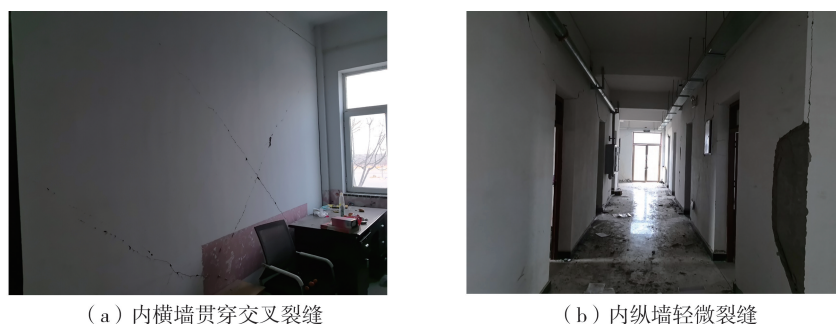
图8 住宿楼震害情况
