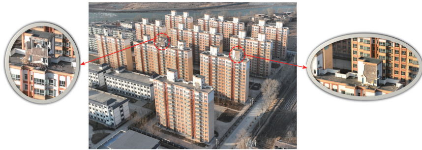
图 12 大河家镇某钢筋混凝土剪力墙结构出屋面楼梯间震害现象
