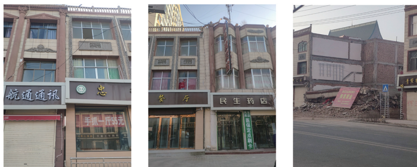
图 15 大河家镇街道两边建筑碰撞破坏现象
