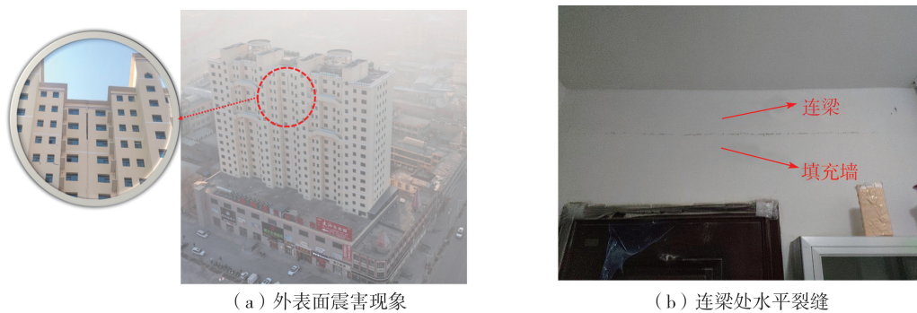
图10 大河家镇某框筒结构震害情况
