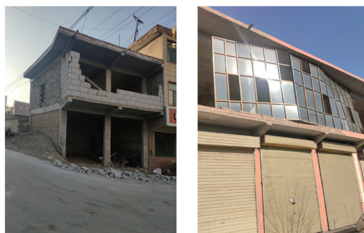
图 16 大河家镇结构悬挑震害
