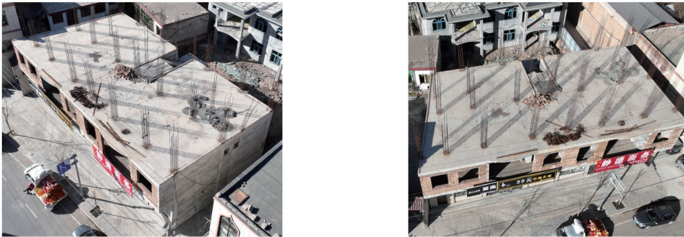
图17 大河家镇某自建框架结构基本完好
