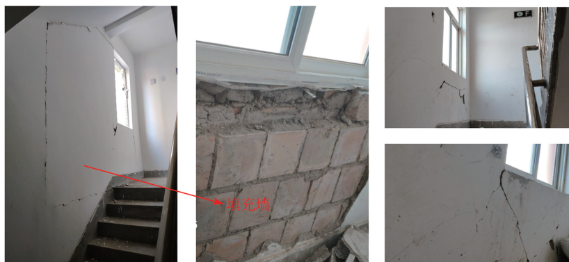
图11 大河家镇钢筋混凝土剪力墙结构楼梯间不同震害现象
