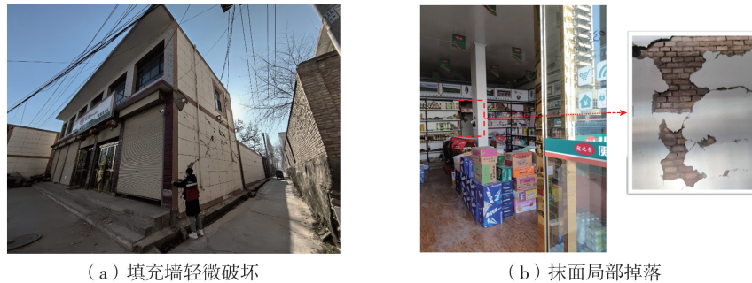
图9 大河家镇某两跨自建框架结构轻微破坏
