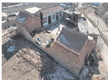
(d) 院墙倒塌
