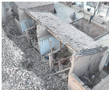
(b) 后侧局部倒塌
