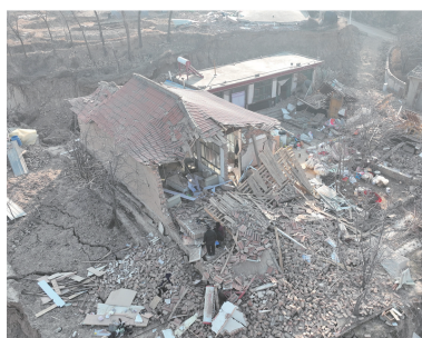
(a) 西侧局部倒塌
