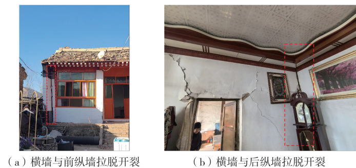
图 8 纵横墙拉脱开裂
