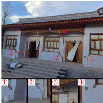
图 9 门窗洞口角部斜裂缝
