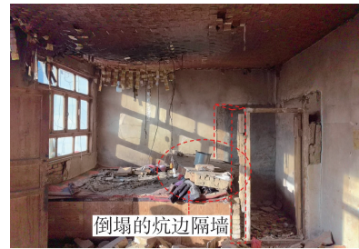
图 11 炕边隔墙倒塌
