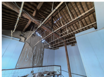
(a) 吊顶掉落
