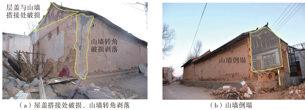
图 20 陈家村的土坯结构民居典型震害
