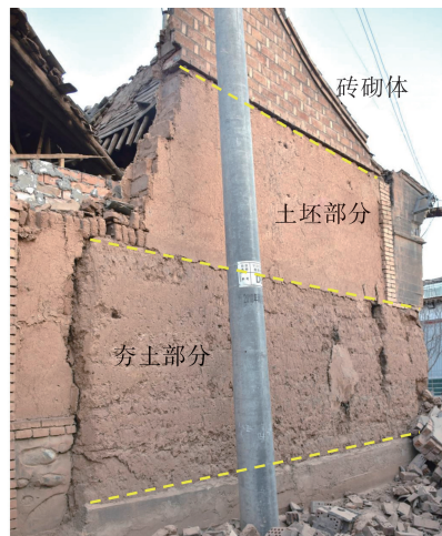
图 21 陈家村的夯土结构民居典型震害
