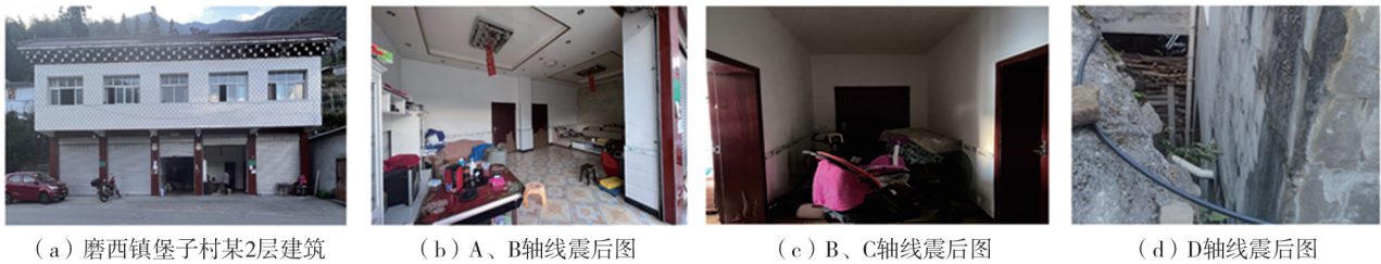
图 17 磨西镇堡子村某 2 层建筑震后图
