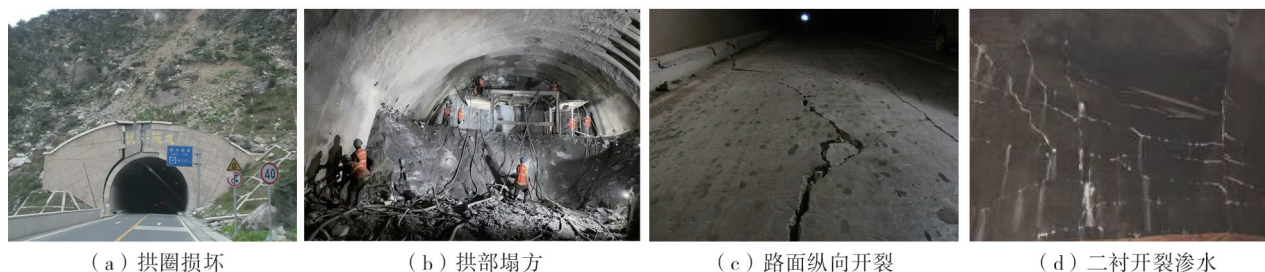
图1 典型隧道震害
